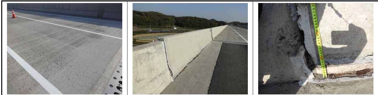
① 교면포장 망상균열 및 A1측 접속슬래브 침하 - 진전 여부확인
