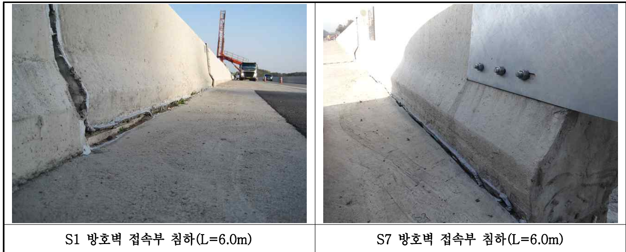
【사진 31.3.24】 방호벽 및 중앙분리대 손상현황
