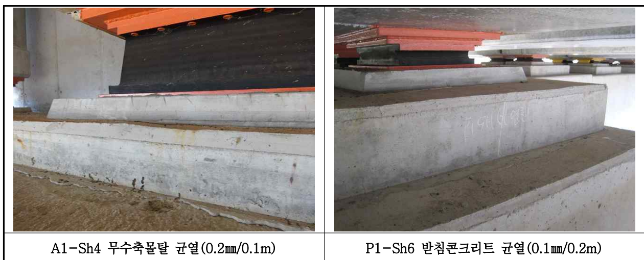
【사진 31.3.36】 교량받침 손상현황
